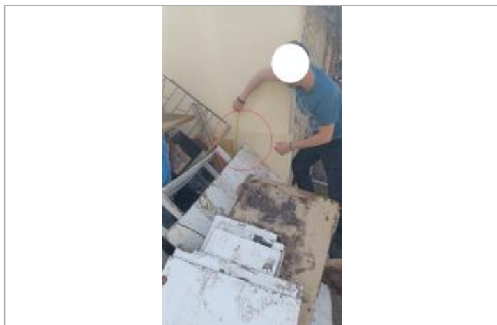
Laisse de crue à 80 cm/sol
