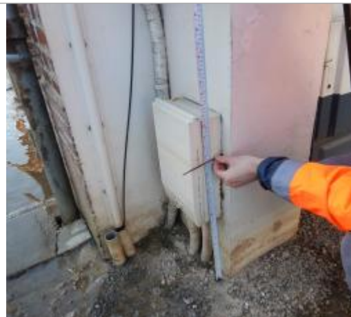
Le site du repère est un coffret électrique.
