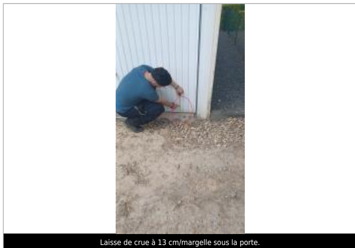
Laisse de crue à 13 cm/margelle sous la porte.
