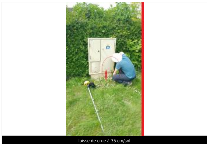
laisse de crue à 35 cm/sol.
