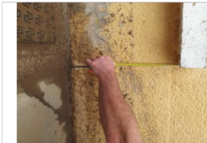
26 cm sous la tablette de la 2ème fenêtre à droite de la porte d'entrée
