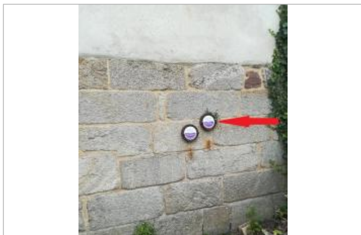
Repère normalisé de la crue de janvier 1995
