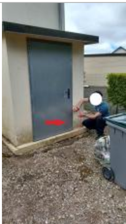
Laisse de crue à 21cm/margelle.
