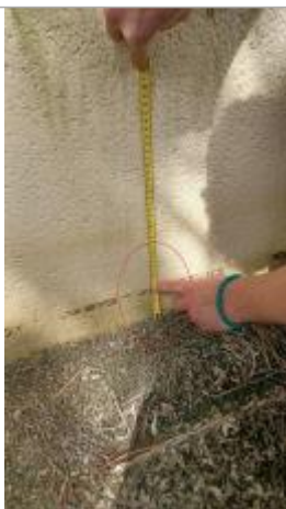
Laisse de crue à 7.5 cm/sol
