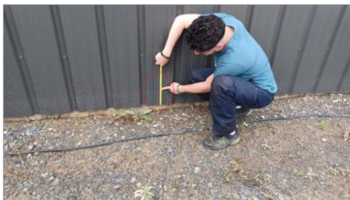
Laisse de crue à 21 cm/sol.
