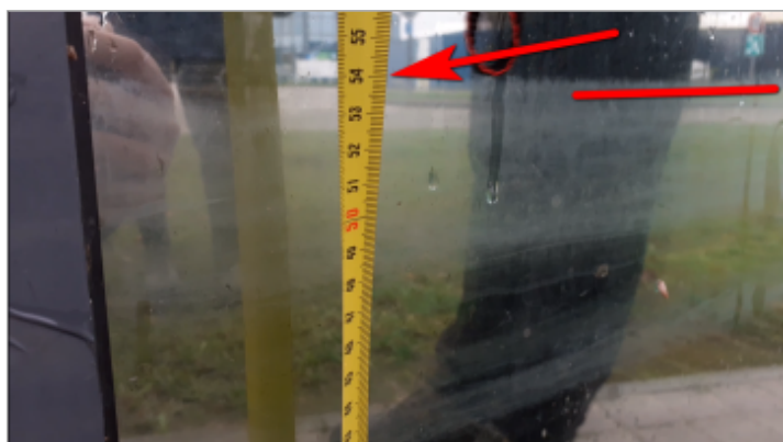
repère sur façade
