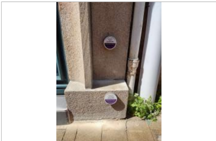
repère de submersion
