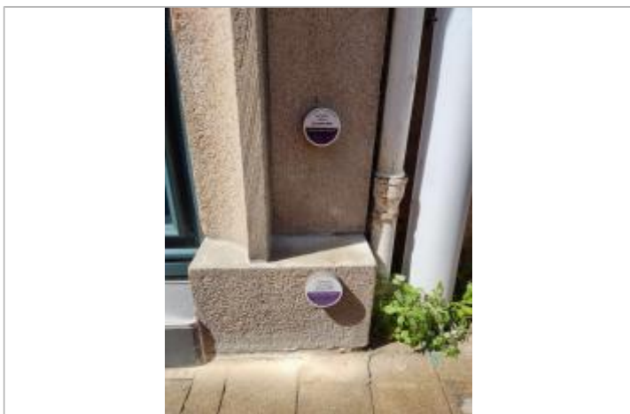
repère de submersion
