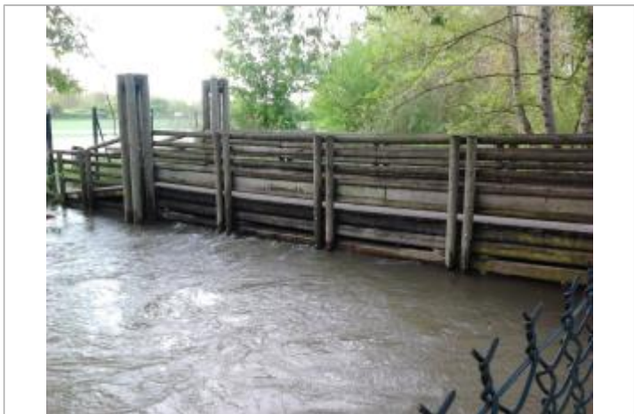
Niveau de débordement du Gourmerault le 05/05/2013 à 18h00
