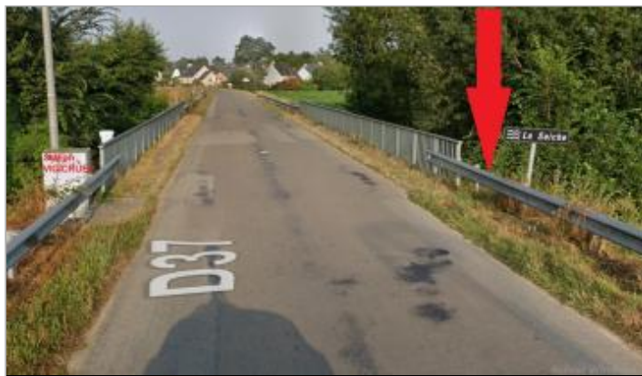
Pont de la RD 37 rive droite de l'autre coté du pont de la station Vigicruces
