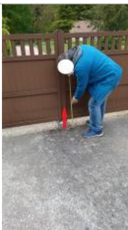
Laisse de crue à 35 cm/sol
