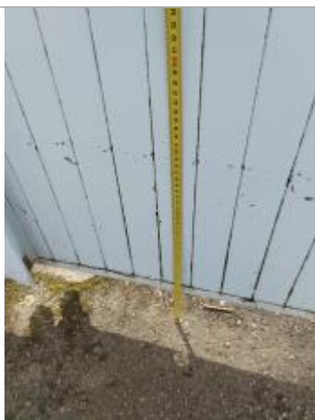
Laisse sur portail à 39cm du sol
