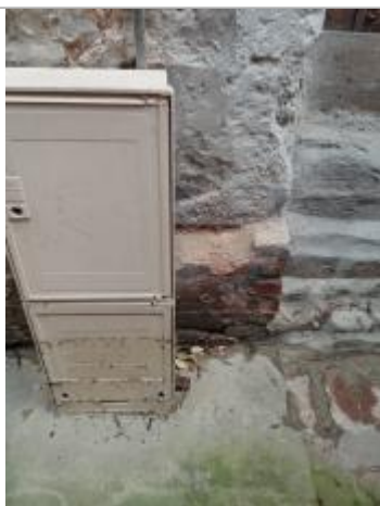
Armoire électrique au fond de l'impasse
