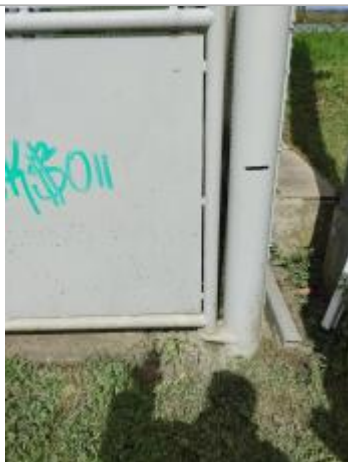
Laisse de végétation au niveau du transformateur
