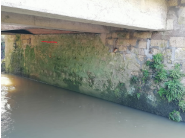
Niveau atteint par la crue symbolisé par le trait rouge, 2024
