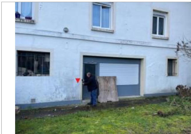
Façade impactée par la crue
