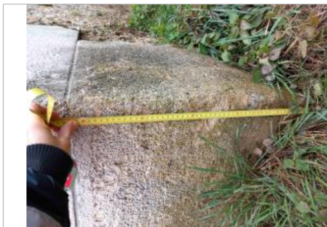
Hauteur de la laisse par rapport au sol
