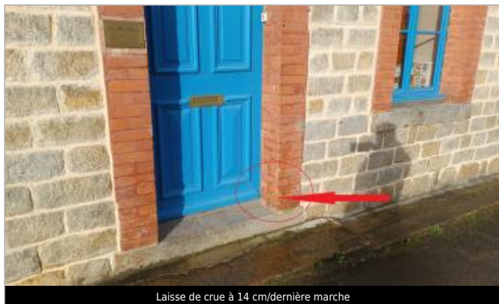
Laisse de crue à 14 cm/dernière marche
