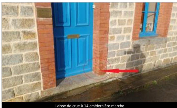
Laisse de crue à 14 cm/dernière marche
