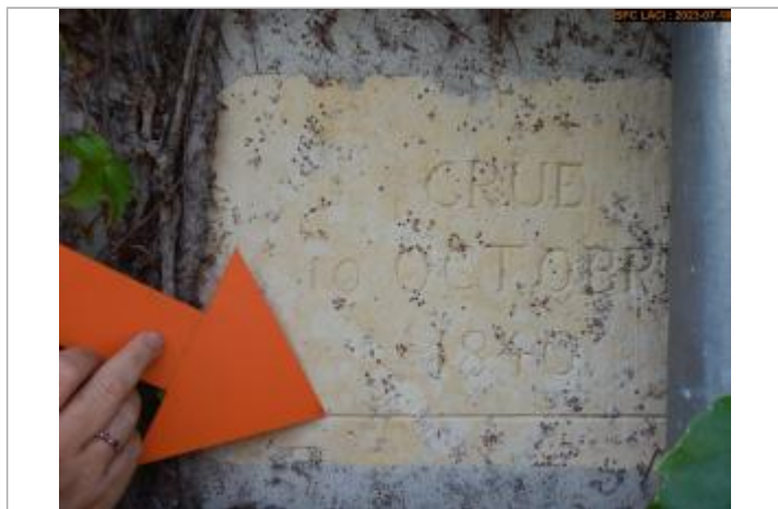
Vue du repère de crue en 2023
