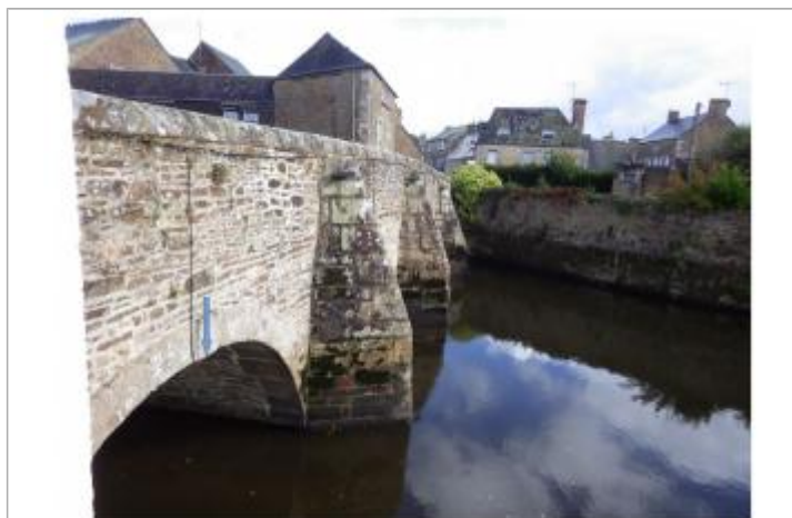
"L'eau était à 5 cm en dessous du tablier du pont de l'arche côté rive gauche".
