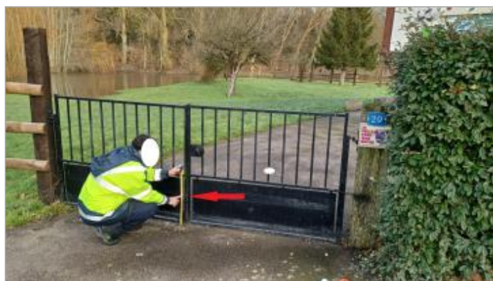
laisse de crue à 32 cm/sol.
