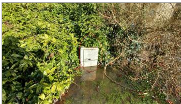
Laisse de crue à 3 cm/ margelle béton sous coffret
