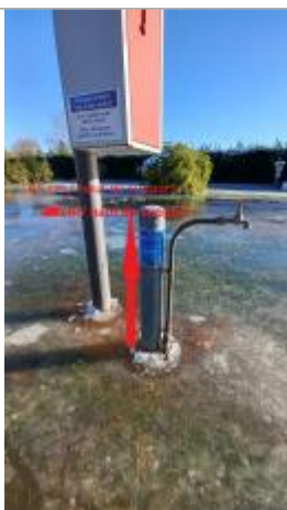
Laisse de crue à 13 cm/sol ou 65 cm/ haut du support du robinet
