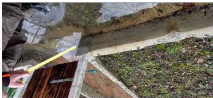
Marque rebord béton
