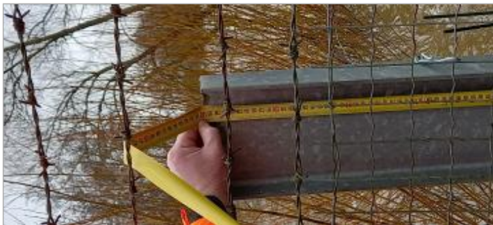
mesure à 140cm à partir du haut du poteau
