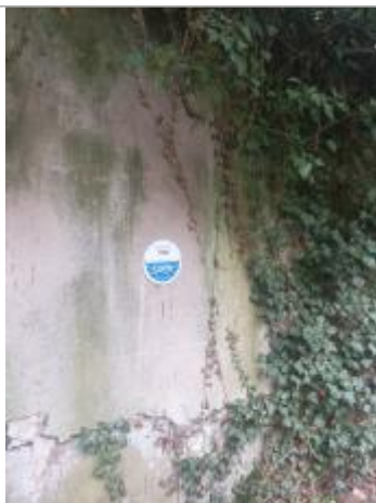
Photo du repère de crue sur le mur de l'usine côté chemin piéton, en 2024
