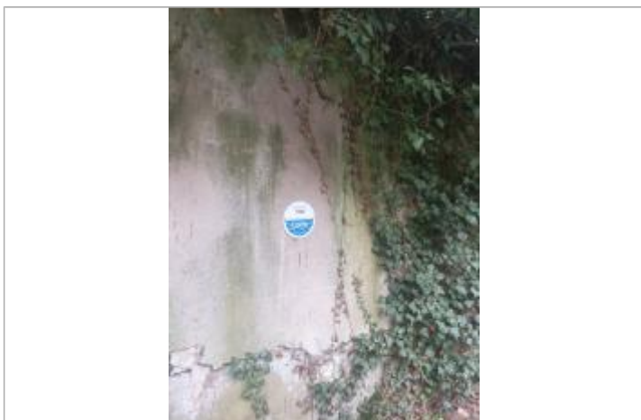
Photo du repère de crue sur le mur de l'usine côté chemin piéton, en 2024
