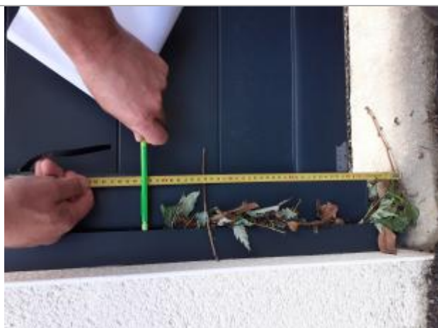
trace de végétation sur portail piéton à 40 cm de hauteur de la margelle
