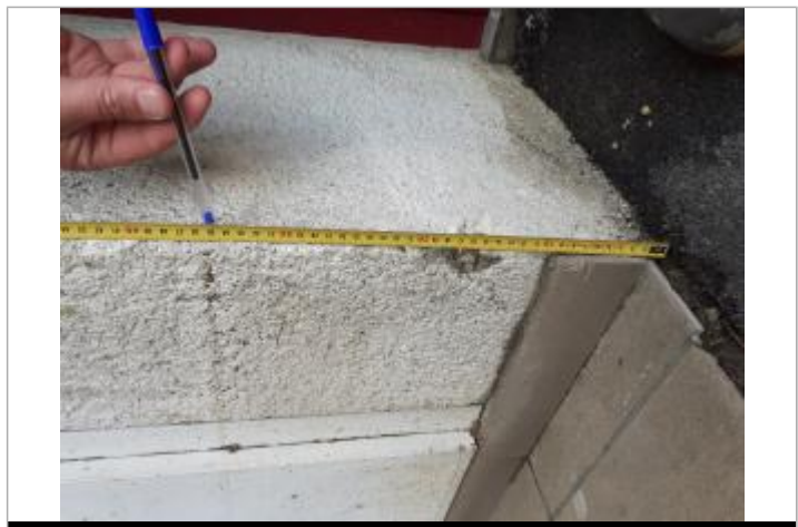
Trace d'eau boueuse à 35 cm du sol bitumé sur mur extérieur du hall d'entrée
