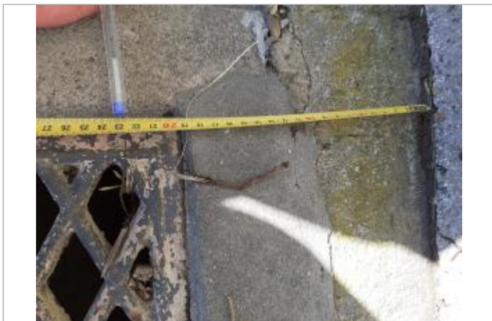
Trace de végétation dans la grille d'aération à 23 cm du sol
