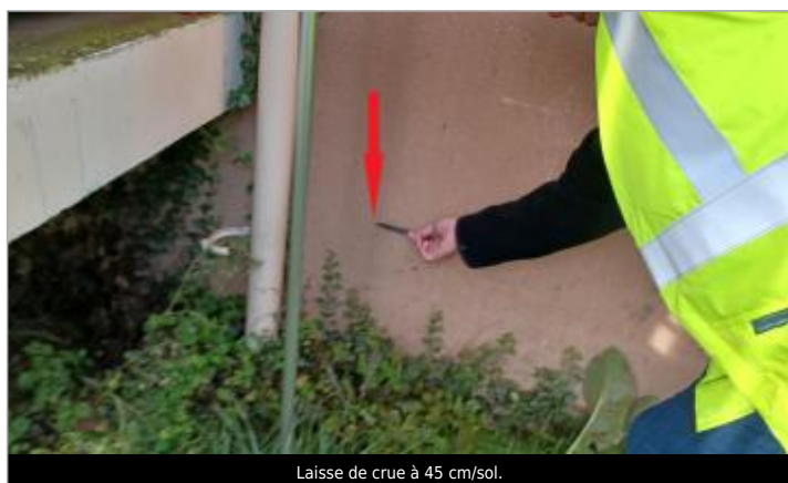
Laisse de crue à 45 cm/sol.
