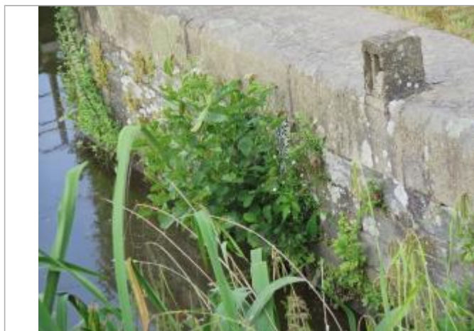
Echelle limnimétrique amont de l'écluse du Comte à Rennes
