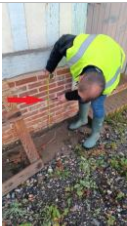
Laisse de crue à 56 cm/sol
