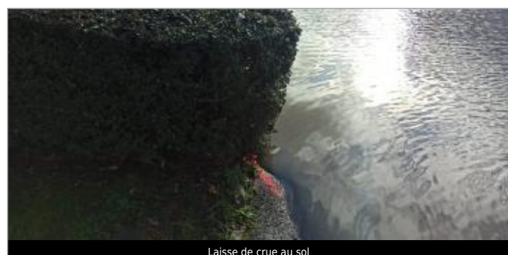
Laisse de crue au sol
