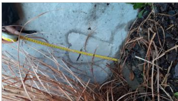
Laisse de végétation sur le mur à 22 cm du sol à partir de la bordure béton
