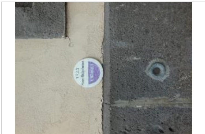
Repère posé sur le bâtiment des services techniques
