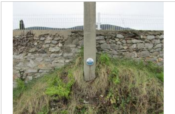
Repère posé sur un poteau électrique
