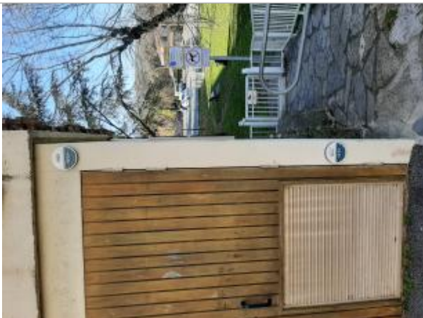
Repère posé sur le transformateur électrique
