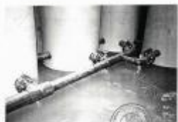
Photo municipale - installation actuelle
