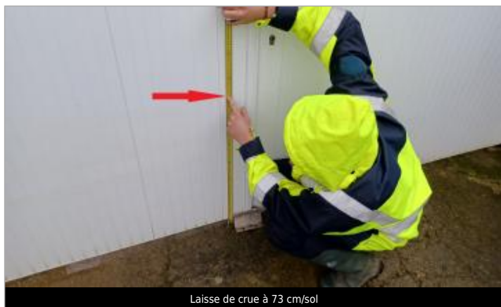
Laisse de crue à 73 cm/sol
