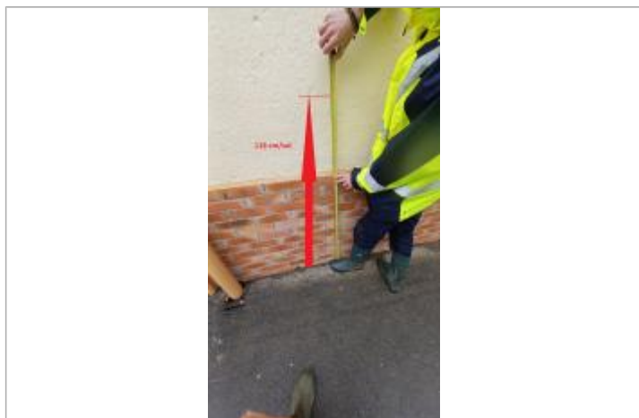
Laisse de crue à 118 cm/sol
