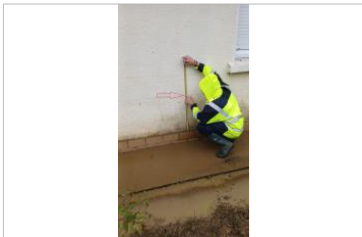
Laisse de crue à 58 cm/sol.
