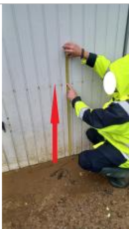
Laisse de crue à 89.5 cm/sol.
