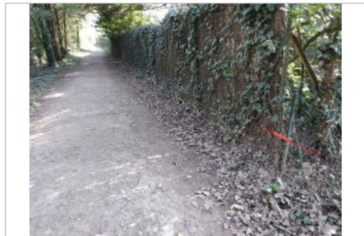
Trace de l'inondation sur le grillage le long du chemin (photo Rennes Métropole)
