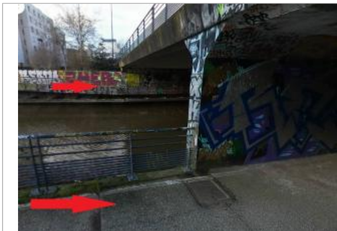
En aval du pont de la rue Saint-Malo (photo de Nicolas Texier - Electrik)
